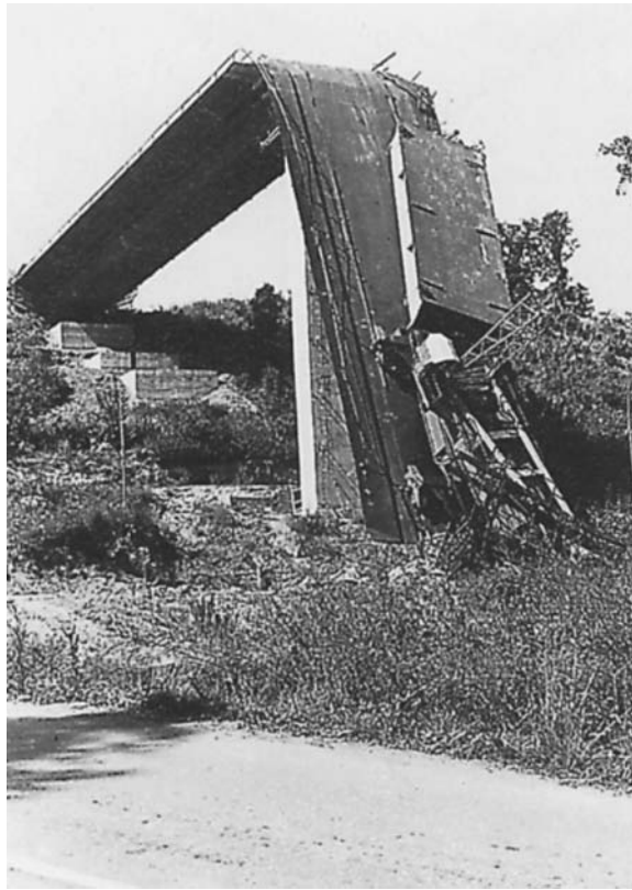
Fig. 17.5 The unexpected and sudden collapse of the Zeulenroda Bridge. (Ekardt: Die Stauseebrücke Zeulenroda. Ein Schadensfall und seine Lehren für die Idee der Ingenieurverantwortung. Stahlbau. With kind permission of Karl-Eugen Kurrer)
