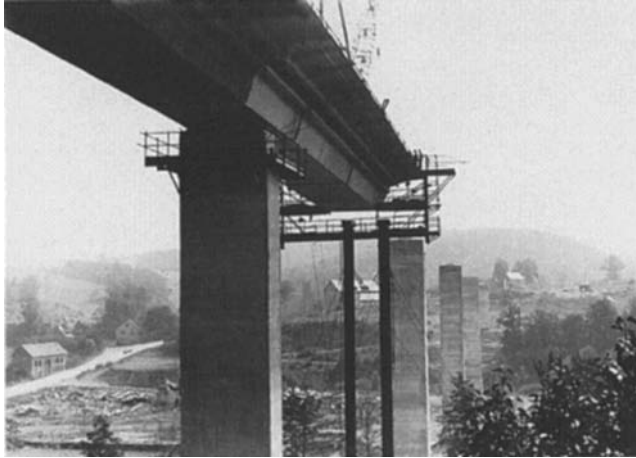
Fig. 17.3 A longitudinal view of the Zeulenroda Bridge during erection. (Ekdart: Die Stauseebrücke Zeulenroda. Ein Schadensfall und seine Lehren für die Idee der Ingenieurverantwortung. Stahlbau. With kind permission of Karl-Eugen Kurrer)
