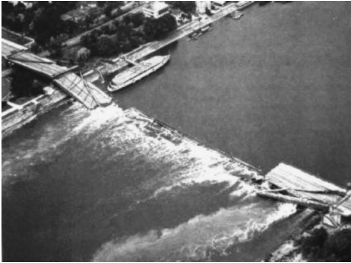
Fig. 18.5 The collapsed Reichsbrücke. ( www.reichsbruecke.net/geschichte_e.php )
