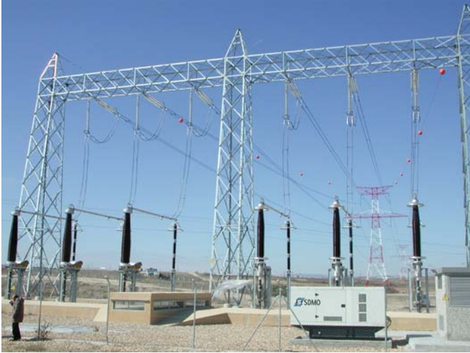
Figure 1.18 Transition compound (Barajas) (Courtesy of RED Eléctrica de ESPAÑA)
