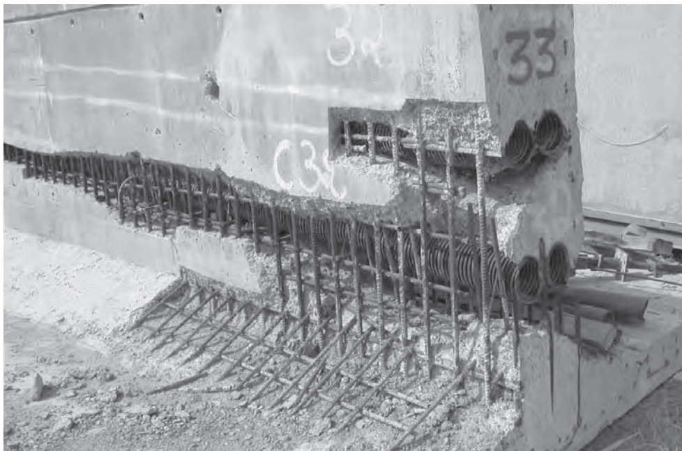
Figure 9.26 Failed web pour (Photo: Robert Benaim)
