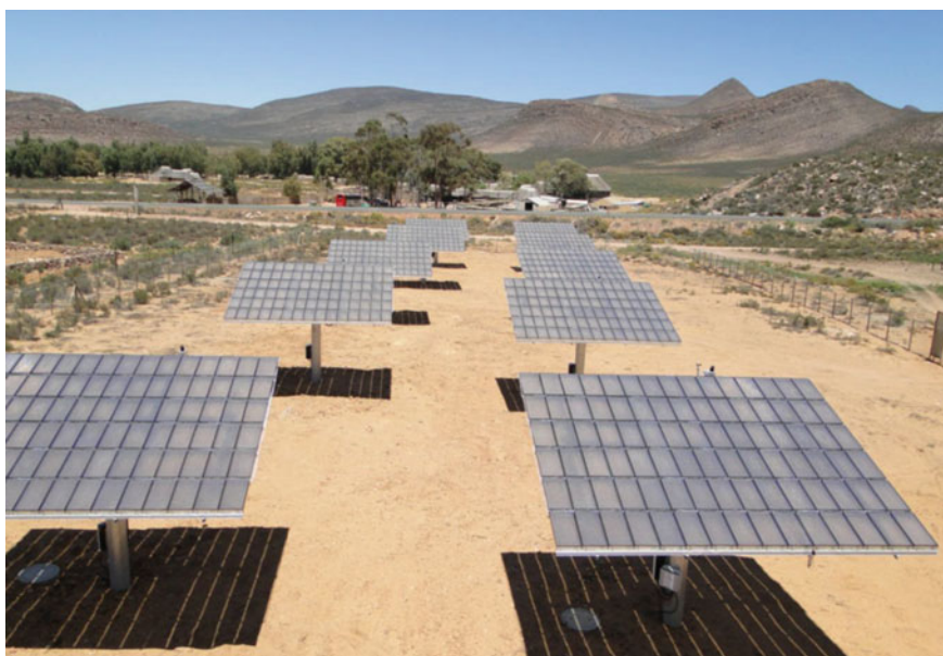
Fig. 21 Touwsrivier HCPV power plant (courtesy of Soitec)
